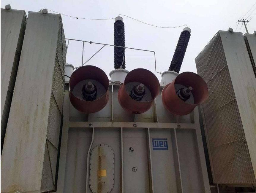
Figura 9 - Detalhe das buchas de BT
