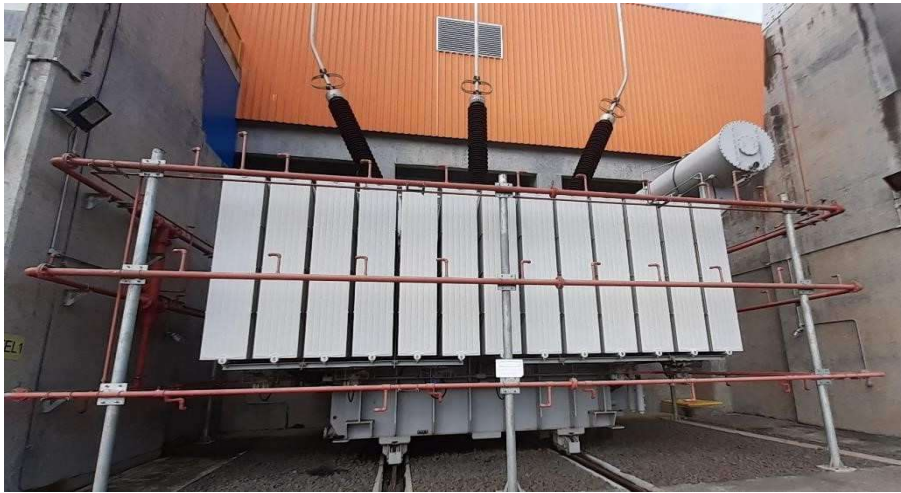
Figura 1 - Vista Frontal do transformador elevador em sua "baia".
