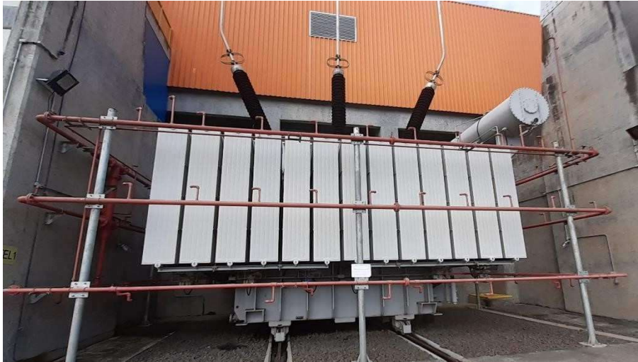
Figura 1 - Vista Frontal do transformador elevador em sua "baia".
