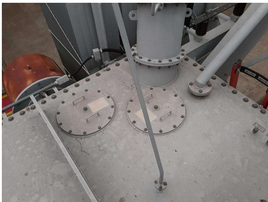
Figura 12- Detalhe das janelas de inspeção na tampa superior e caneco da H0 e tubulação rele 63T
