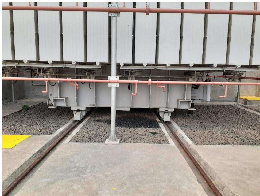
Figura 3 - Vista frontal do transformador na sua "baia" e posição das rodas e trilhos.
