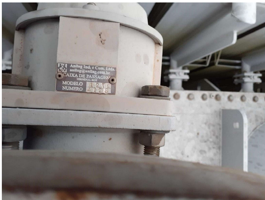
Figura 13 - Detalhe da caixa de passagem dos TCs das buchas de AT.
